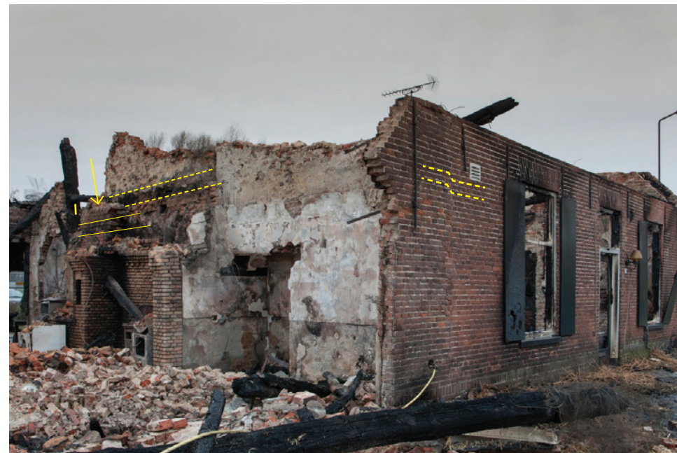
42. De noordzijde van het woonhuis na de brand. Links de posities van de dubbele balk. De 'stroomlaag' bij de pijl geeft aan dat er onder een balk gemetseld is. Rechts de aansluiting van de stal- en woonhuisgevels. F. Roefs
